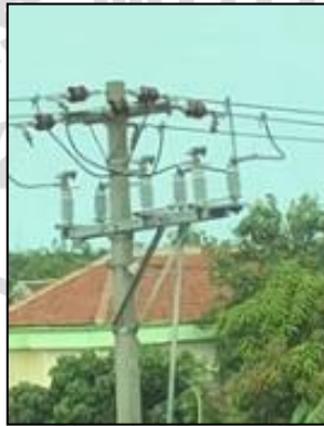
Gambar 2.11 LBS manual di jaringan distribusi 20 kV
