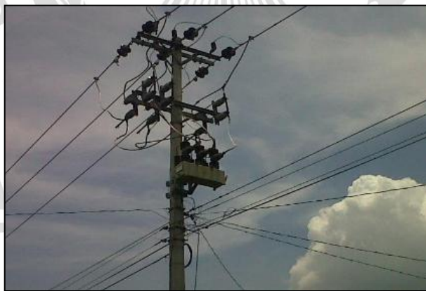
Gambar 2.10 Recloser di jaringan distribusi 20 kV
