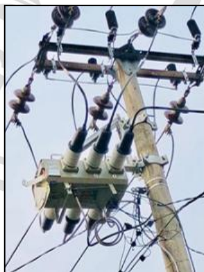
Gambar 2.12 LBS Motorized di jaringan distribusi 20 kV
