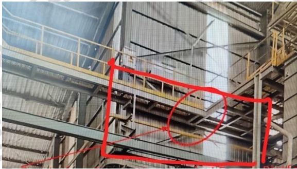
Kerusakan Bagian Dalam
