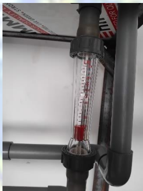
Lampiran 11 Pemasangan flowmeter
