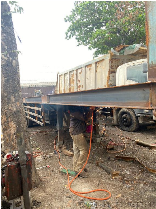
Pekerja bengkel tidak menggunakan APD saat bekerja
