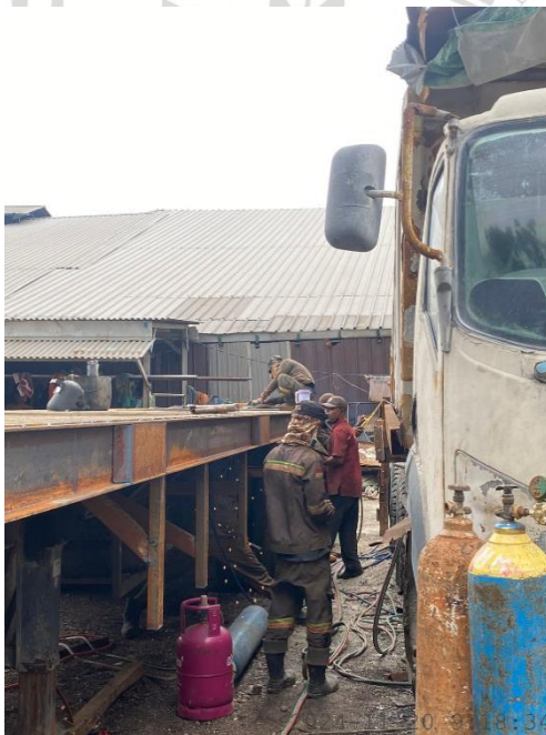
Pekerja bengkel tidak menggunakan APD saat bekerja
