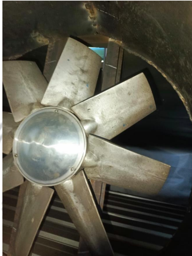
Gambar 3. 6 Blower 18inc pada oven briket
