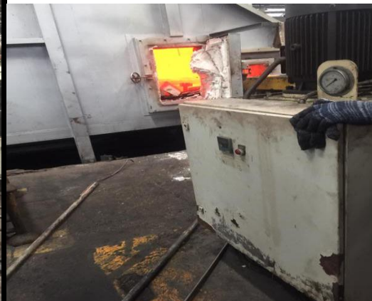
Gambar 2.2 kerusakan pada beam
