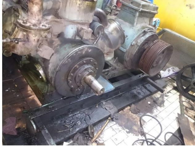
Gambar Mesin Kompresor Grasso dan Komponen Yang Rusak
