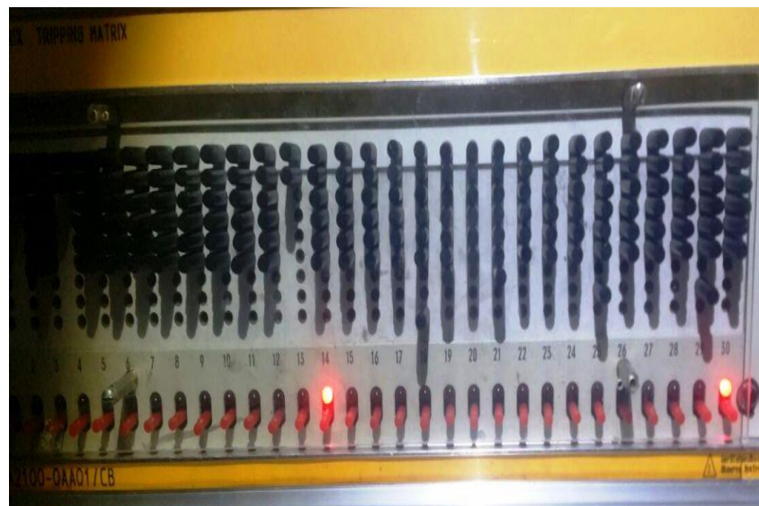
Gambar 3.3 Indikasi Alarm pada Matriks 14 & 30
