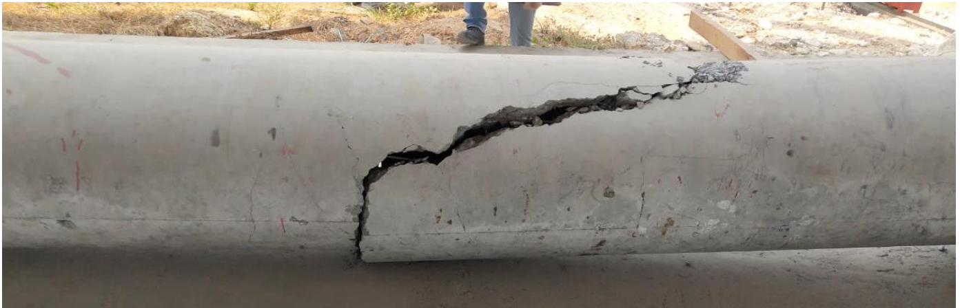
Produk Spun pile cacat Retakan
