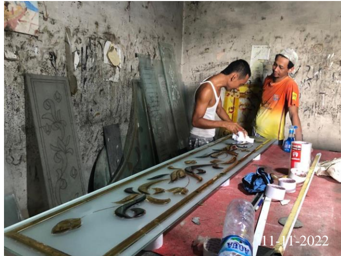
Pekerja tidak memakai APD pada saat bekerja
