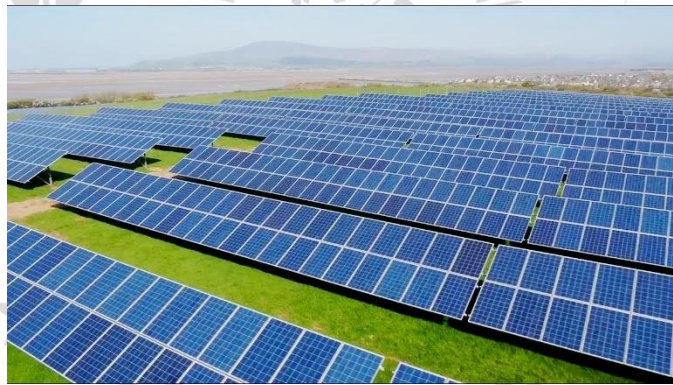
Gambar 2. 1 Pembangkit Listrik Tenaga Surya
