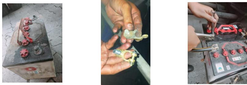
Gambar 3. Jenis Kerusakan Accu pada Unit Head Truck-B44 (Sumber : Dokumentasi di PT. Bima pada site Pelabuhan Berlian, 2022)
