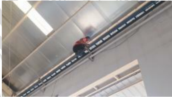
Penggantian Kabel LAN Versi CAT 4 ke CAT 6
